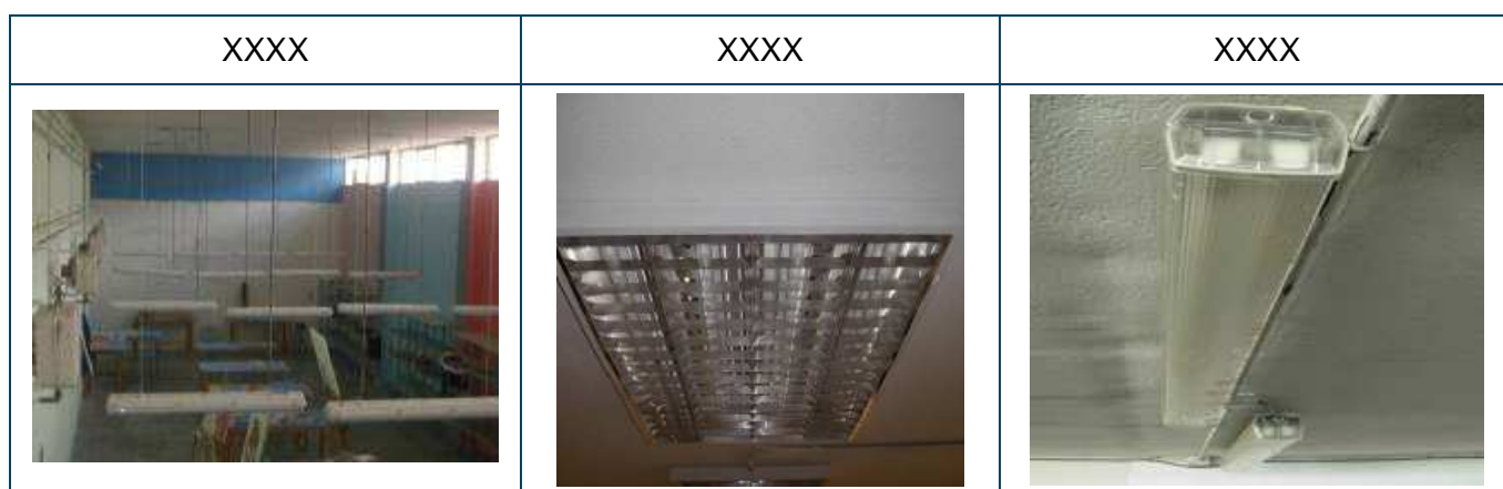
Figura 1 Imagen de Iluminación Interior
