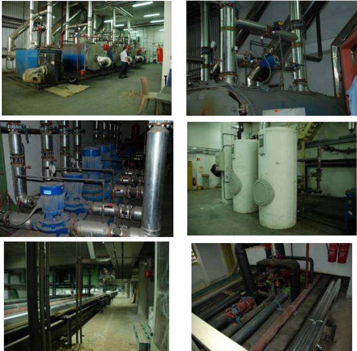
Figura 7 Imágenes Sala de Instalaciones Centralizadas
