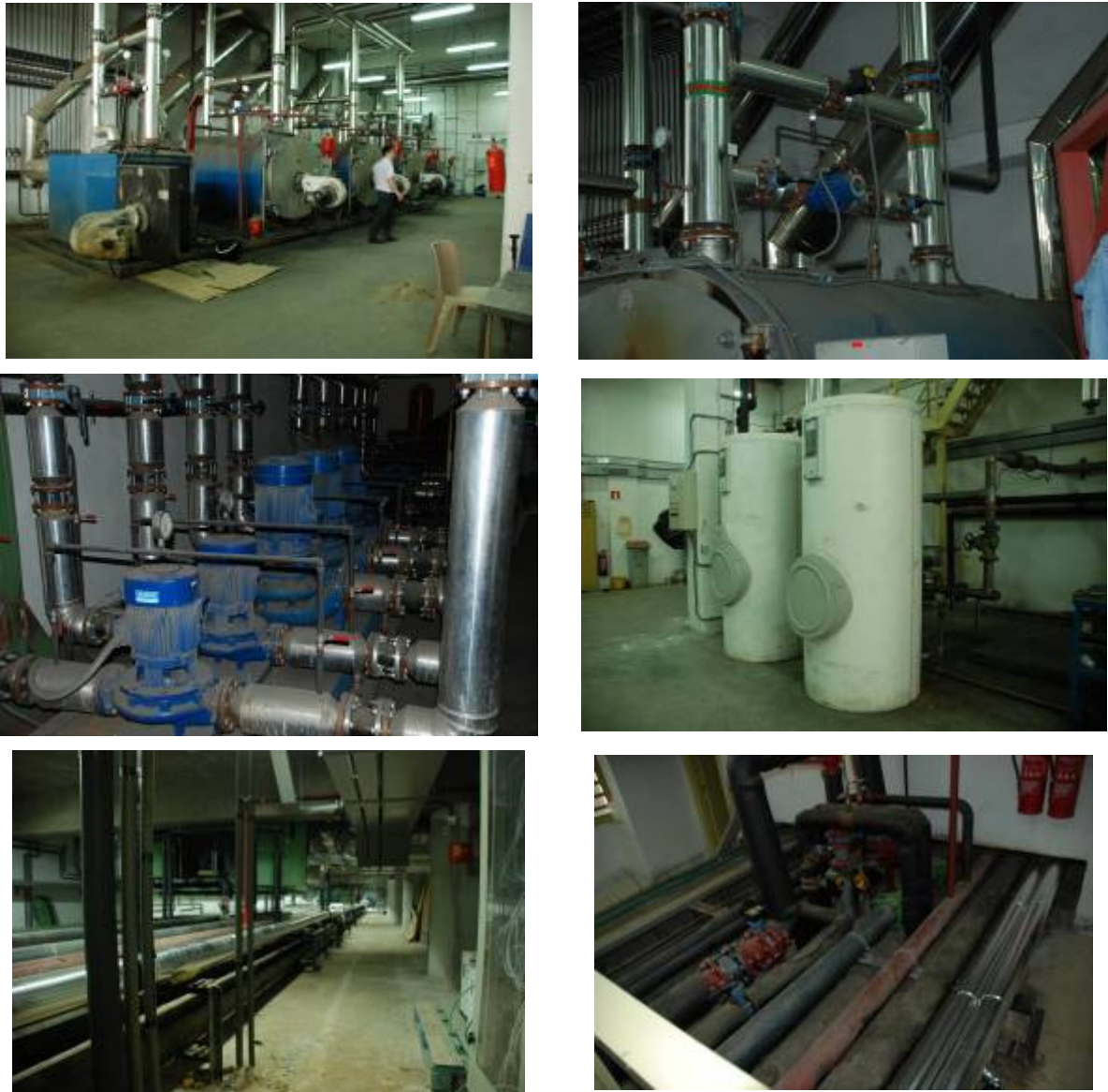
Figura 7 Imágenes Sala de Instalaciones Centralizadas
