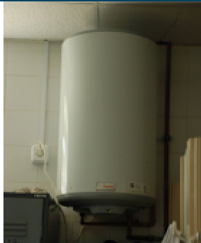
Figura 6 Imágenes de Acumuladores y Termos
