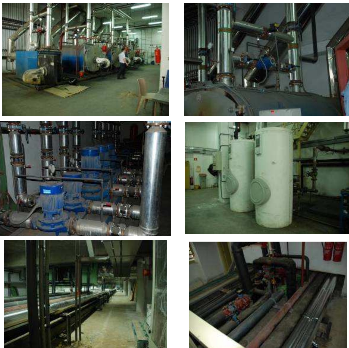
Figura 7 Imágenes Sala de Instalaciones Centralizadas
