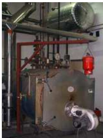
Figura 10 Imagen de Generador de Vapor
