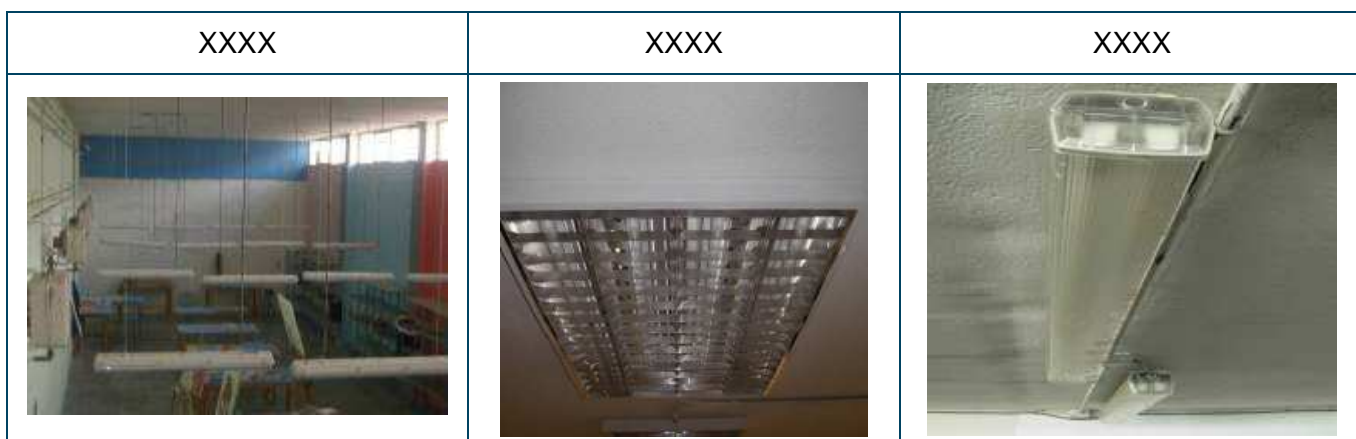
Figura 1 Imagen de Iluminación Interior
